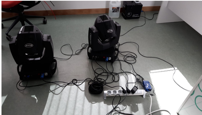
Figura 4.4: Conexión de los focos al controlador (el bloque azul de la derecha)
